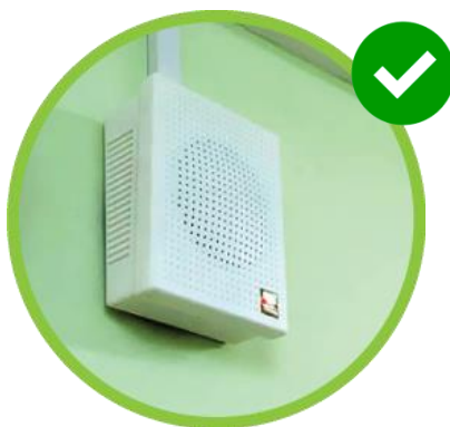
Аудиотрансляция в здании (при необходимости)
